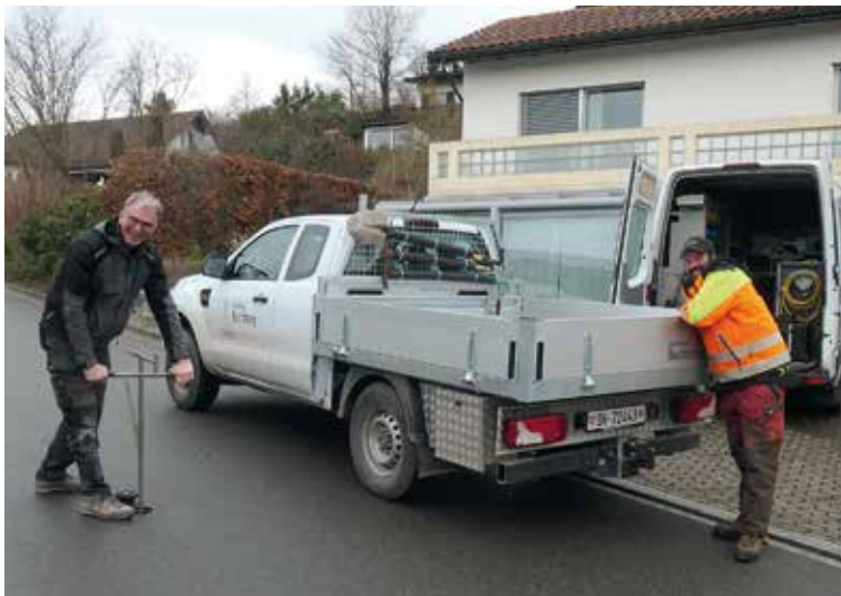
Fritz Streuli und Daniel Häderli stoppen den Wasseraustritt beim Rohrbruch
