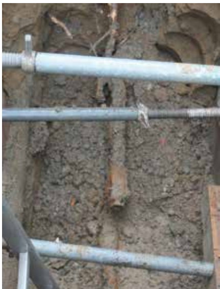
Die defekte Gussleitung in knapp zwei Meter Tiefe
