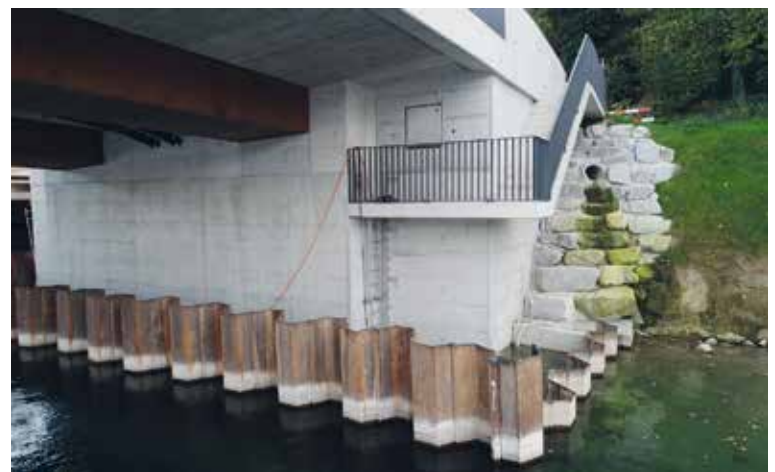
Der neue Bau wird sicher wieder viele Jahrzehnte allen Anforderungen standhalten - Bilder von Otto Haller
