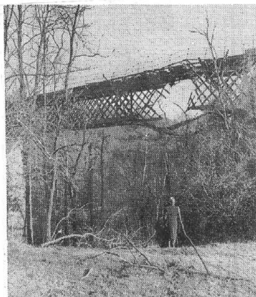
Bombenschaden an der alten Brücke von Zweidlen am 9. November 1944
